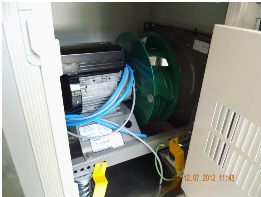
Foto 13: Ventilatorkammer Fortluft Innenansicht
