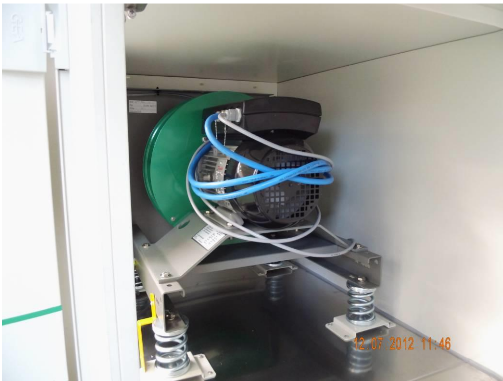
Foto 11: Ventilator Zuluft Innenansicht
