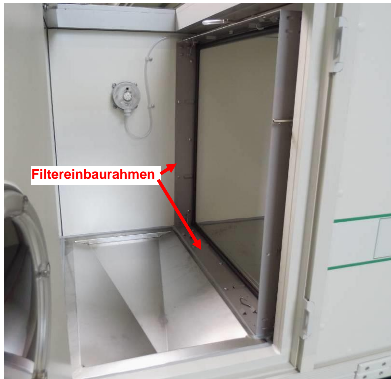
Foto 6: Filterkammer Zuluft Innenansicht
